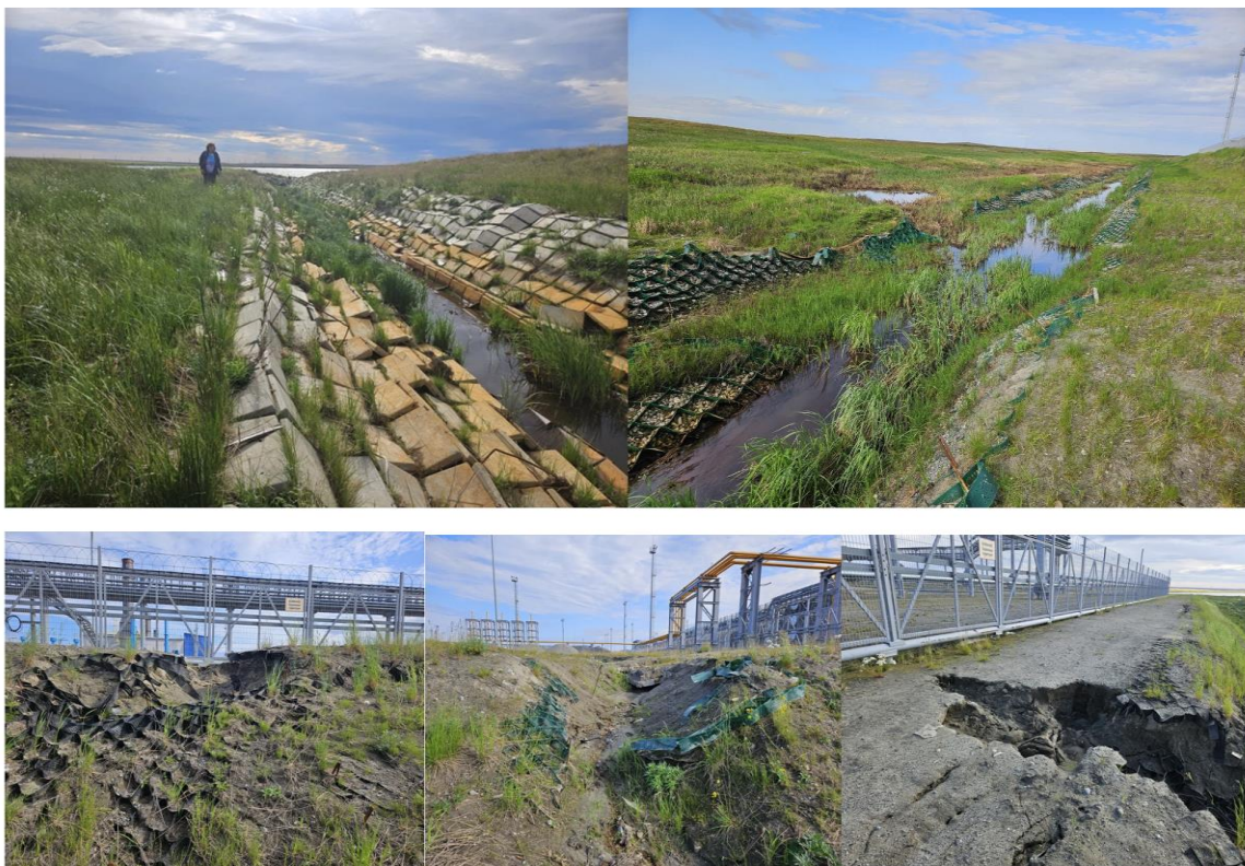
Рис.27. Овраг в районе компрессорной станции Ярынская
