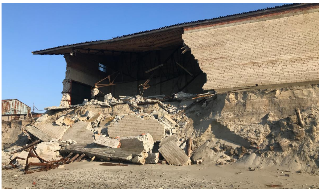
Рис. 5. Обвалившийся угол здания цеха, поселок Варандей
