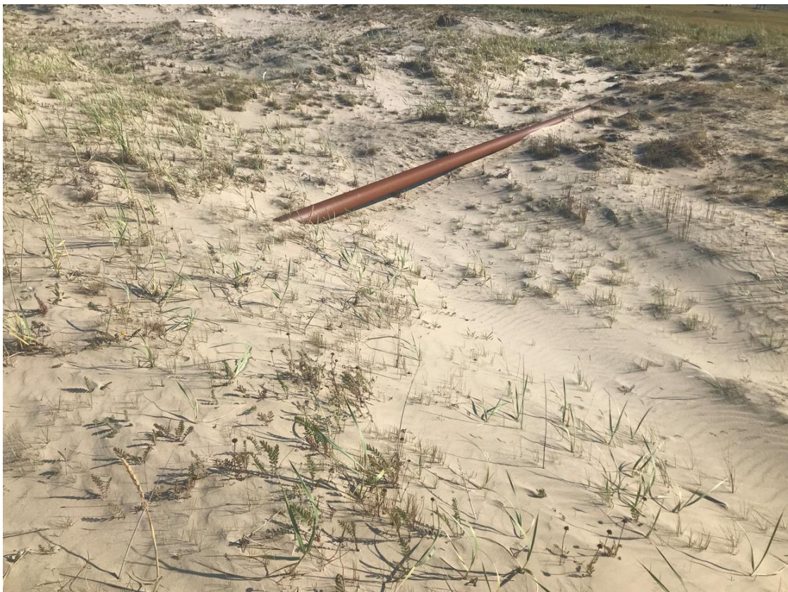
Рис. 11. Трубопровод, оголившийся под действием эоловых процессов
