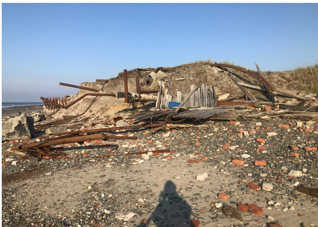
Рис. 8. Поврежденный трубопровод, торчащий из берегового уступа в районе пос. Варандей
