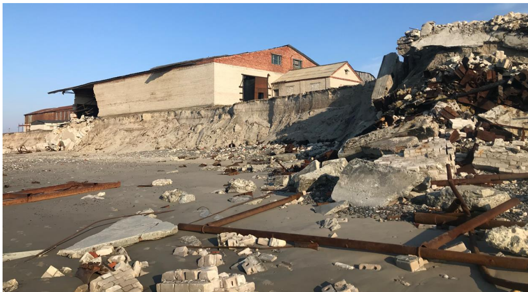
Рис. . Обвалившийся угол здания цеха, поселок Варандей
